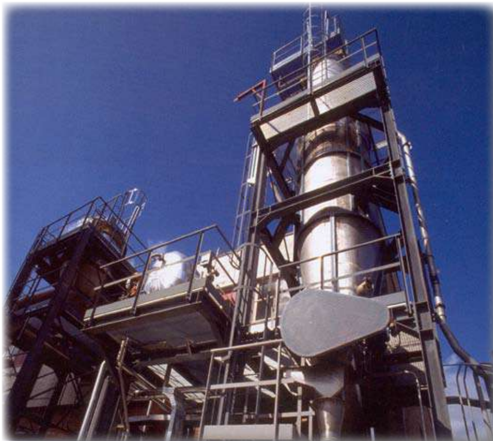
Particolare dell'impianto Steam Explosion
