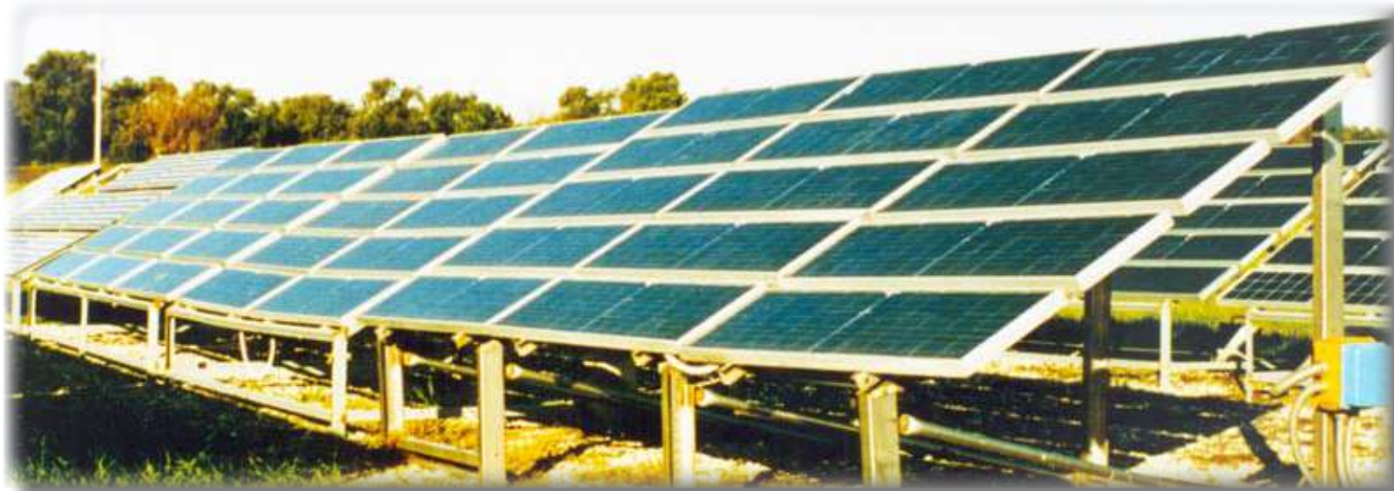
Pannelli fotovoltaici - impianto FARE (Fonti Alternative e Risparmio Energetico)
