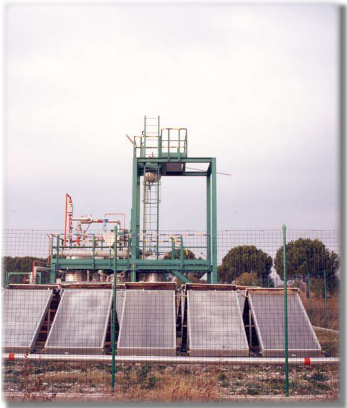
Impianto dimostrativo DEWAL, pompa solare per l'estrazione di acqua di falda
