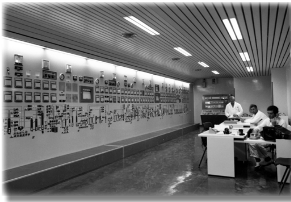
Sala Controllo dell'impianto ITREC
