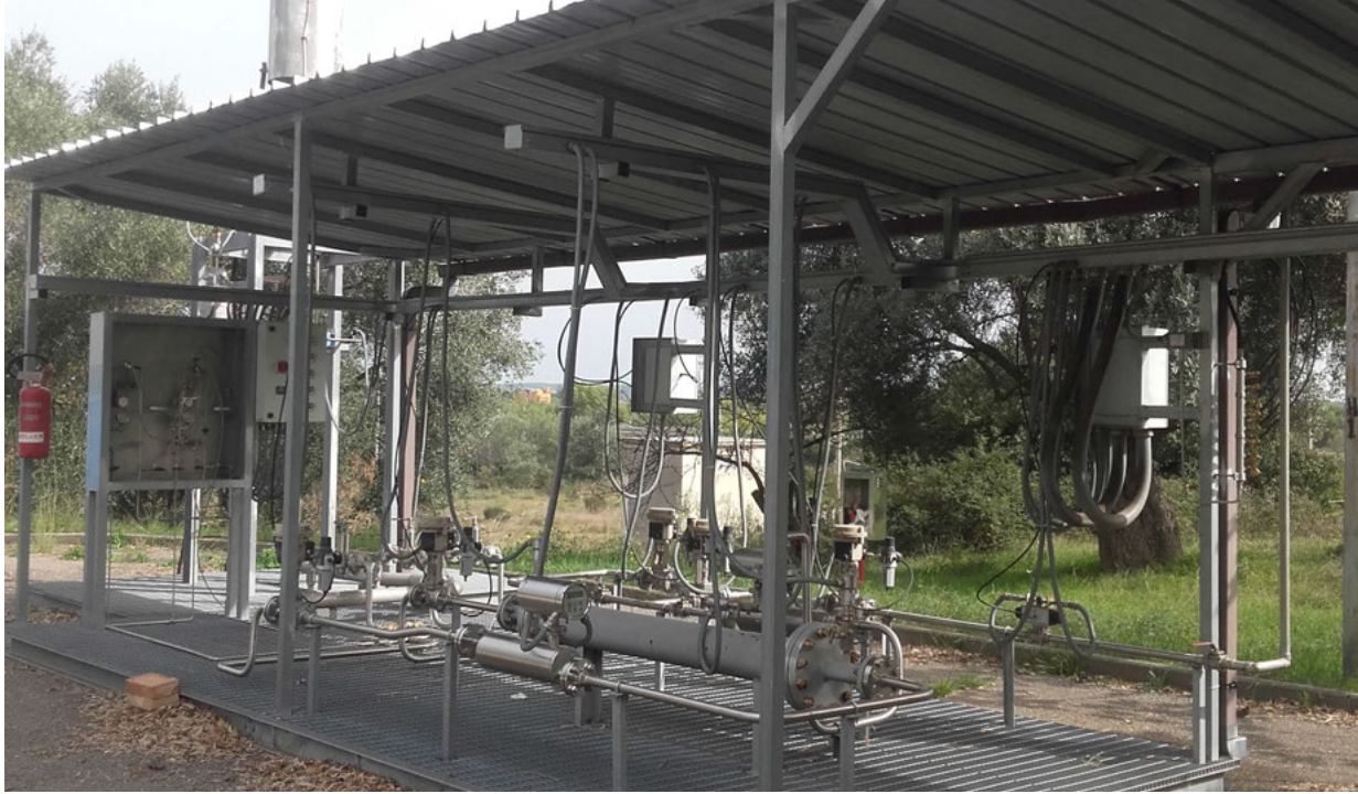
Fig. 31: Impianto per l'Upgrading del biogas mediante tecnologia a membrane
