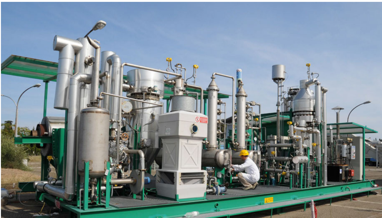
Figura 37: Impianto SICAV per la pirolisi e lo steam reforming per la produzione di carboni attivi syngas da biomasse e rifiuti
