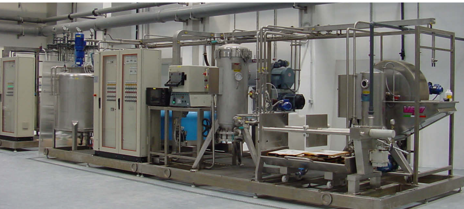
Figura 42: Particolare dell'impianto modulare CRISMAT
